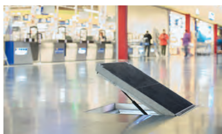
Tampon de visite à ouverture assistée abritant les connexions techniques dans une galerie marchande
