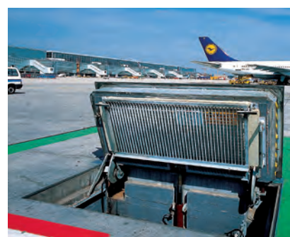
Tampon de visite permettant l'accès aux réseaux techniques sous la piste d'un aéroport
