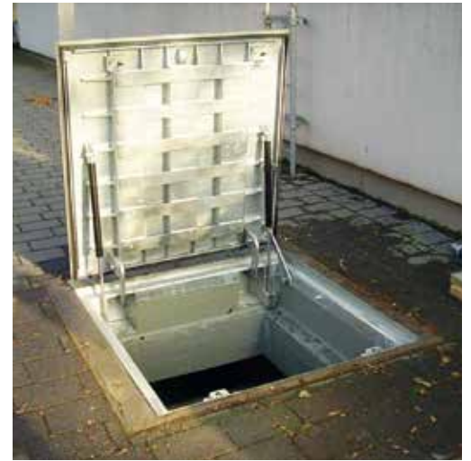
En extérieur : trappe assistée pour un accès facile aux réseaux divers
